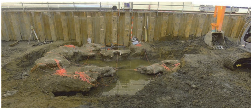
写真 1 汚染源掘削調査により発見されたコンクリート様の塊 (2005(平成 17)年 1 月 27 日撮影)
