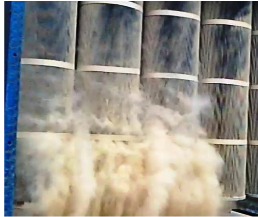
写真Ⅲ-3 フィルタ自動再生状況
