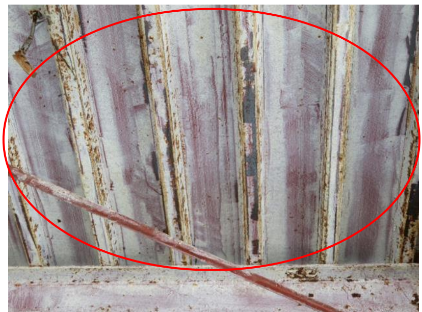
鉄骨デッキプレート部の 石綿含有吹付けひる石の 取り残し(剥離剤併用手工 具ケレン工法)
