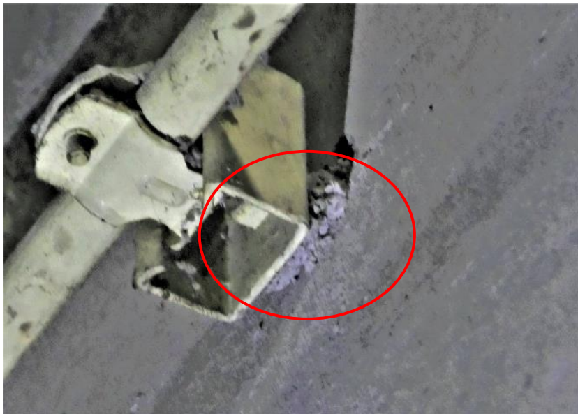
電線管ダクター部の清掃不良
