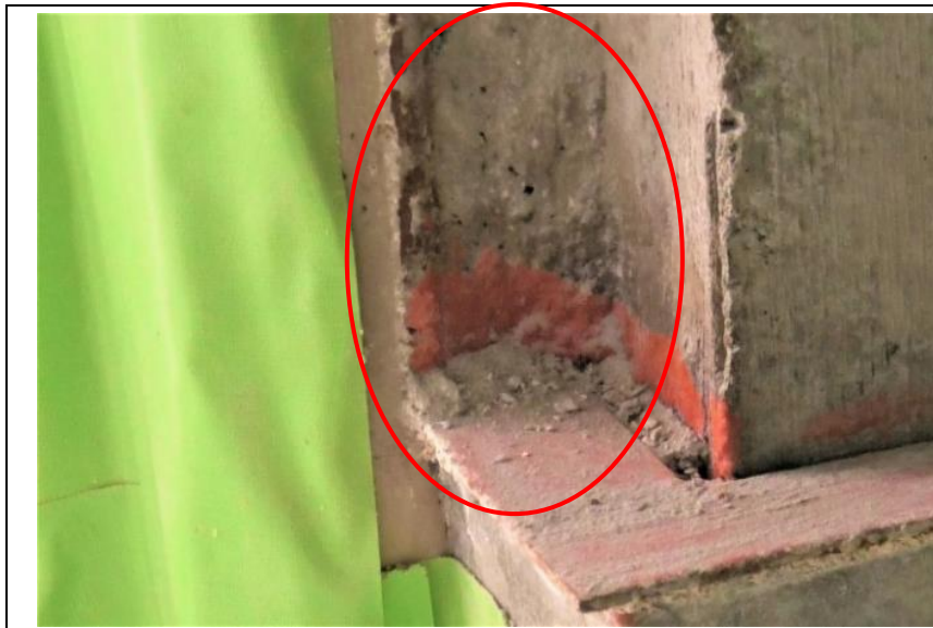
腰壁入隅部の清掃不良
