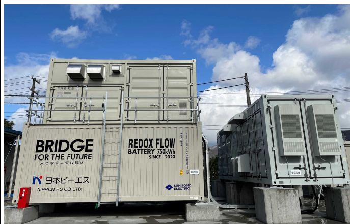
左 : 電池コンテナ20ft×3台 右 : PCSコンテナ30ft
