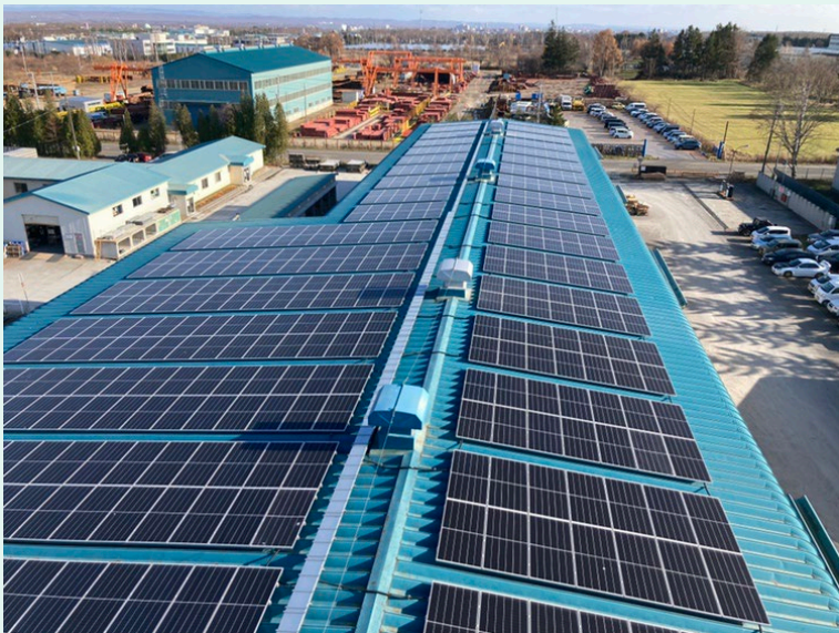
太陽光発電設備
