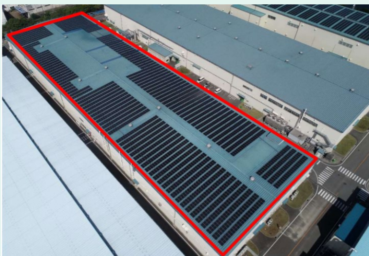
太陽光発電設備
