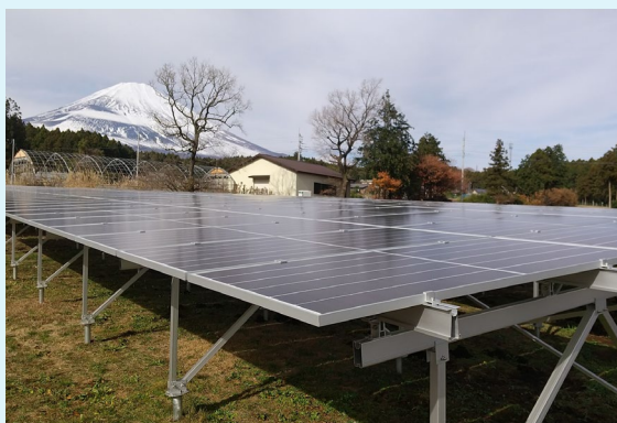
太陽光発電所①
