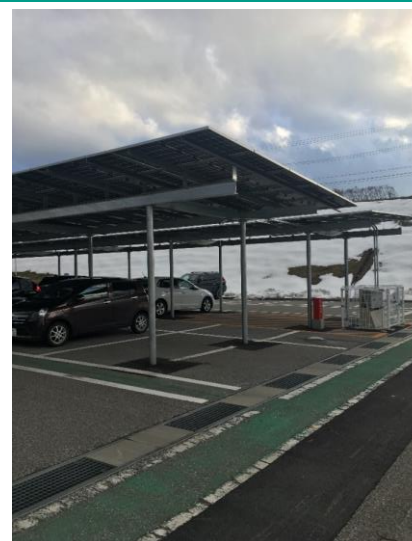
写真 ソーラーカーポート設置状況
