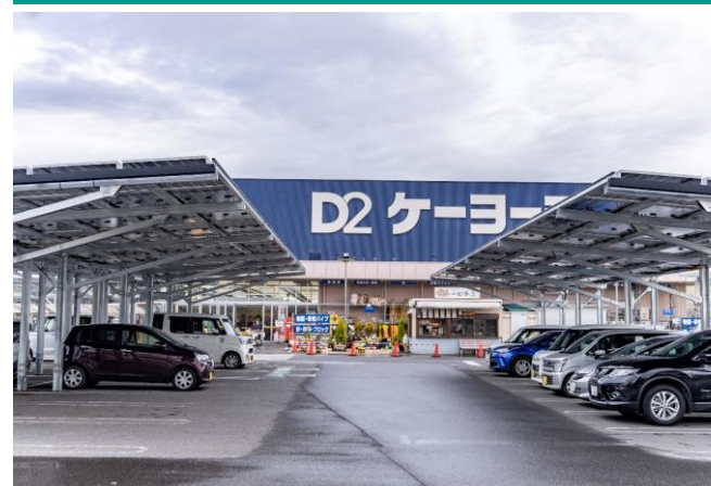
写真 ソーラーカーポート設置状況
