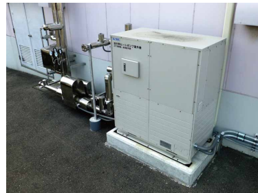
地中熱利用ヒートポンプ（室外機）
