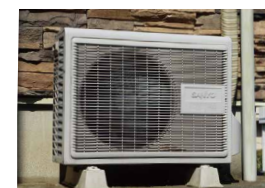
空気熱源ヒートポンプ
