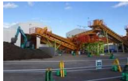
楢葉町の仮置場内破碎選別設備 出典：環境省
