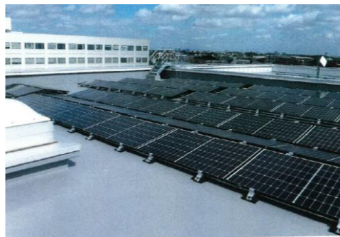
事務センターの太陽光発電設備
