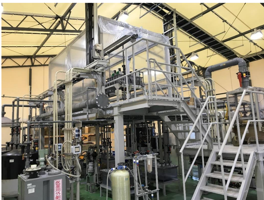
図 3. 4. 1-2 湿式回収実証試験設備の外観
