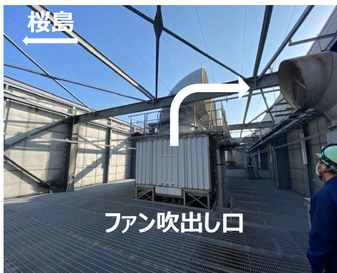
【焼却施設の冷却塔（北部清掃工場）】
