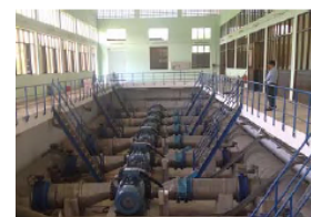
高効率ポンプ （ベトナム）
