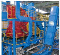
金属破碎・選別設備
