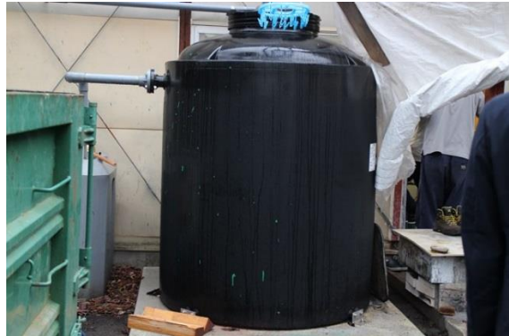
鍍金作業場の廃液タンク
