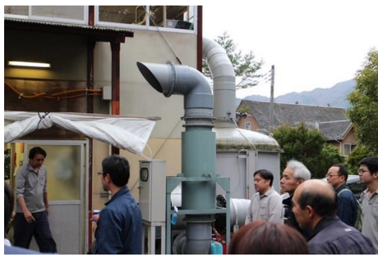
鍍金作業場の排ガス処理設備。活性炭フィルタによって水銀を吸着
