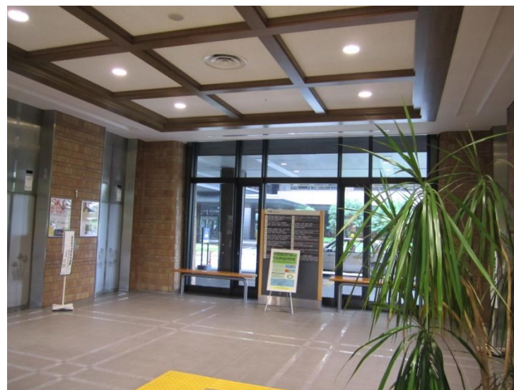
県庁本館1階LED照明
