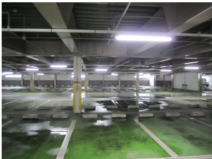
県庁南側駐車場LED照明
