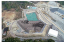
土壌貯蔵施設(双葉①工区)
