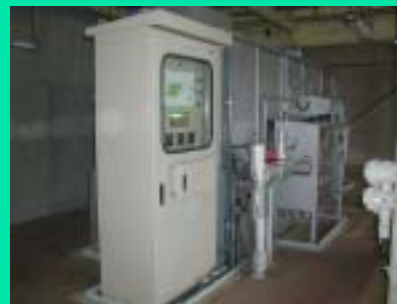
燃焼による排出抑制設備
