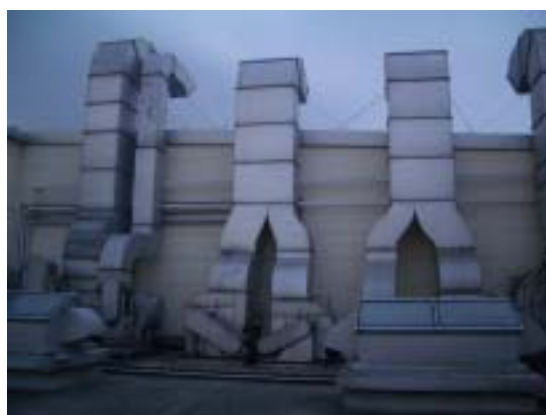
排気口群 (印刷機械ごとの排気口)
