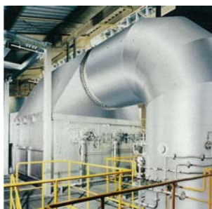
↑ 脱硝反应塔外观(一部分)
