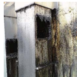
排出口の油汚れ
