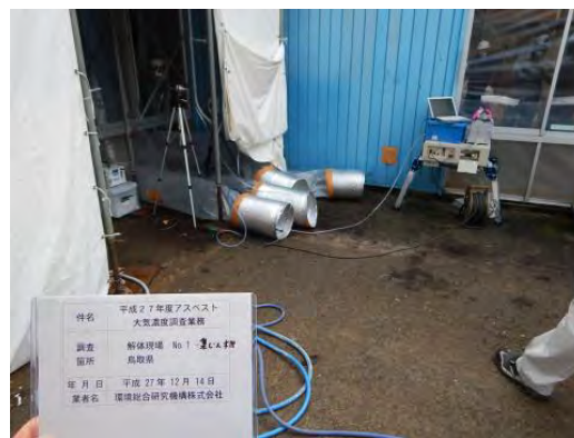
調査地点②(集じん機排気口)
