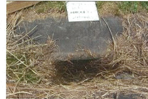
濃度の高い水が検出された側溝の状況
